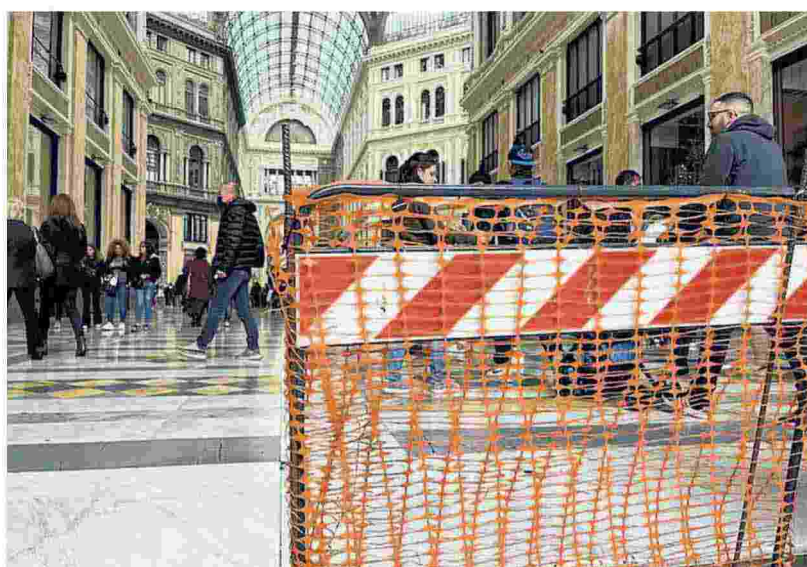
▲ Le transenne Pavimentazione rotta nel lato San Carlo della Galleria
